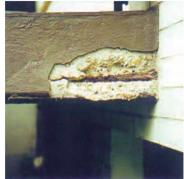
Balkon-Betonkragplatte mit Abplatzung durch Konstruktionsspannungen
